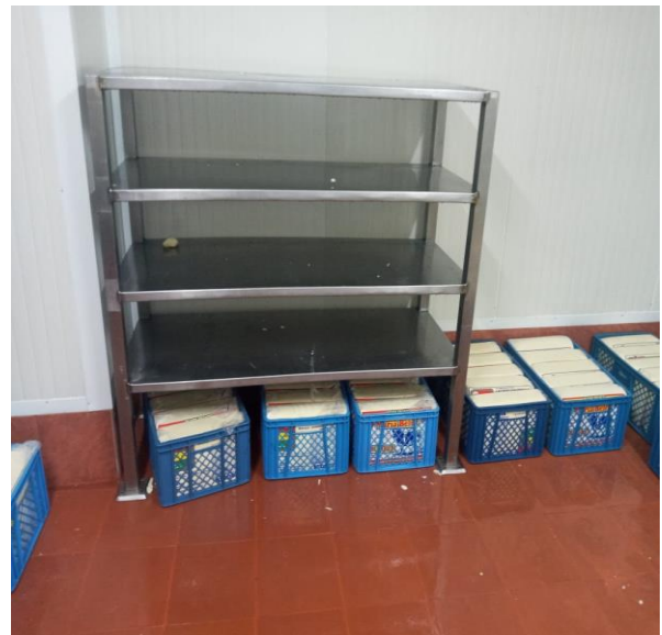
Fotografía 16. Estanterías cuarto frio
