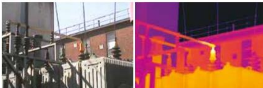
Figura 9. Instalación eléctrica de alta tensión
