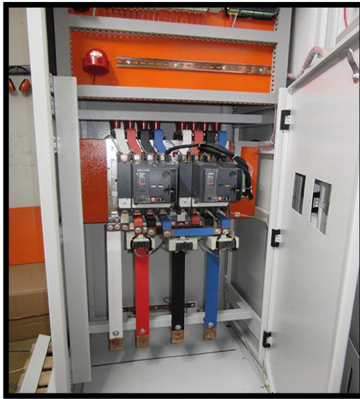
Figura 12. Tablero de transferencia automática.
