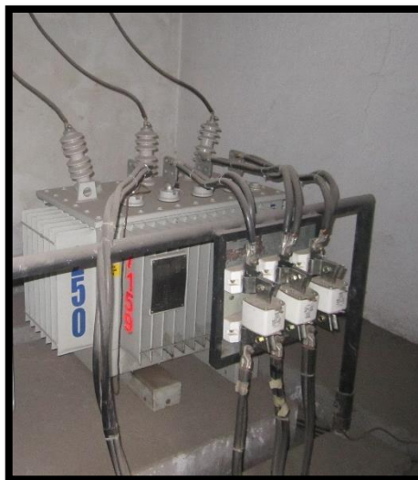
Figura 9. Transformador de 250 kVA 13.8 kV-220 V.
