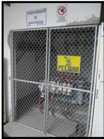
Figura 8. Cámara de transformación Compañía Alimenticia Agua Santa.
