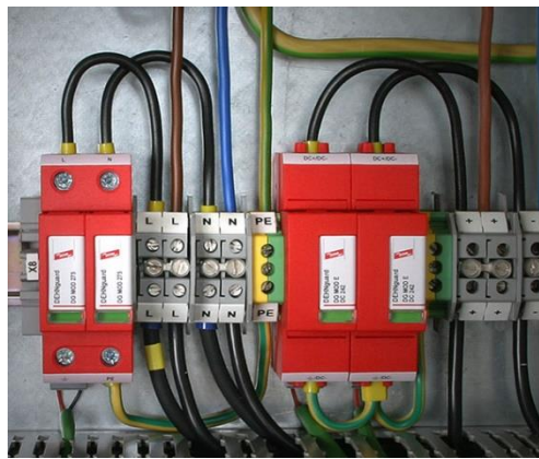
Figura 44. Supresor de transcientes instalado en un tablero de distribución para la envasadora de agua Ultralimpia.
