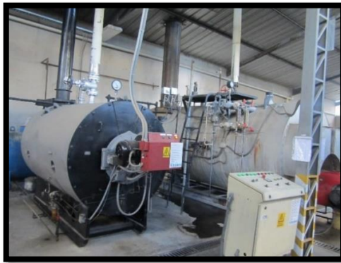
Figura 5. Instalaciones eléctricas industriales, calderos trifásicos.
