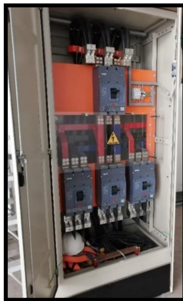
Figura 6. Tablero de distribución eléctrica, capacidad 800 Amperios con Disyuntores Caja Moldeada.
