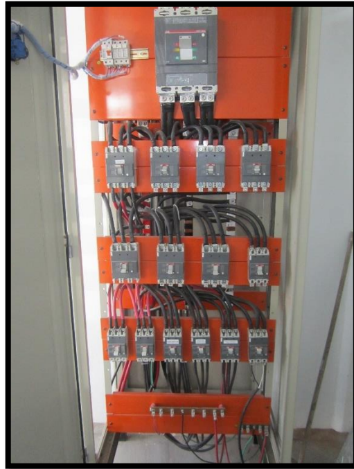
Figura 11. Tablero de distribución.
