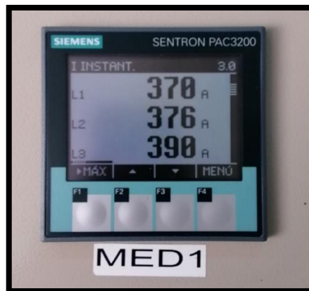
Figura 39. Instalación y funcionamiento del medidor de energía marca SIEMENS SENTRON PAC 3200.
