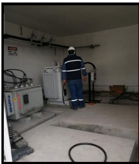
Figura 35. Ubicación del transformador de 500 kVA.
