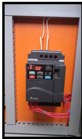
Figura 3.13 Espacio libre alrededor del VFD
