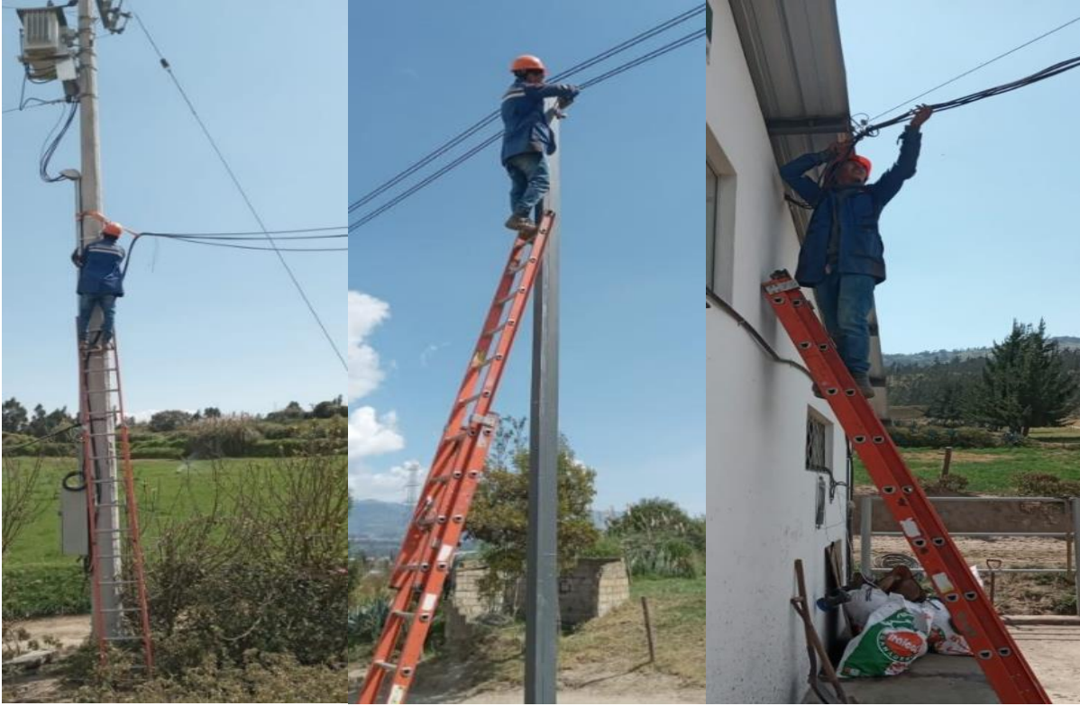
Imagen 8. Verificación del cambio del conductor AWG
