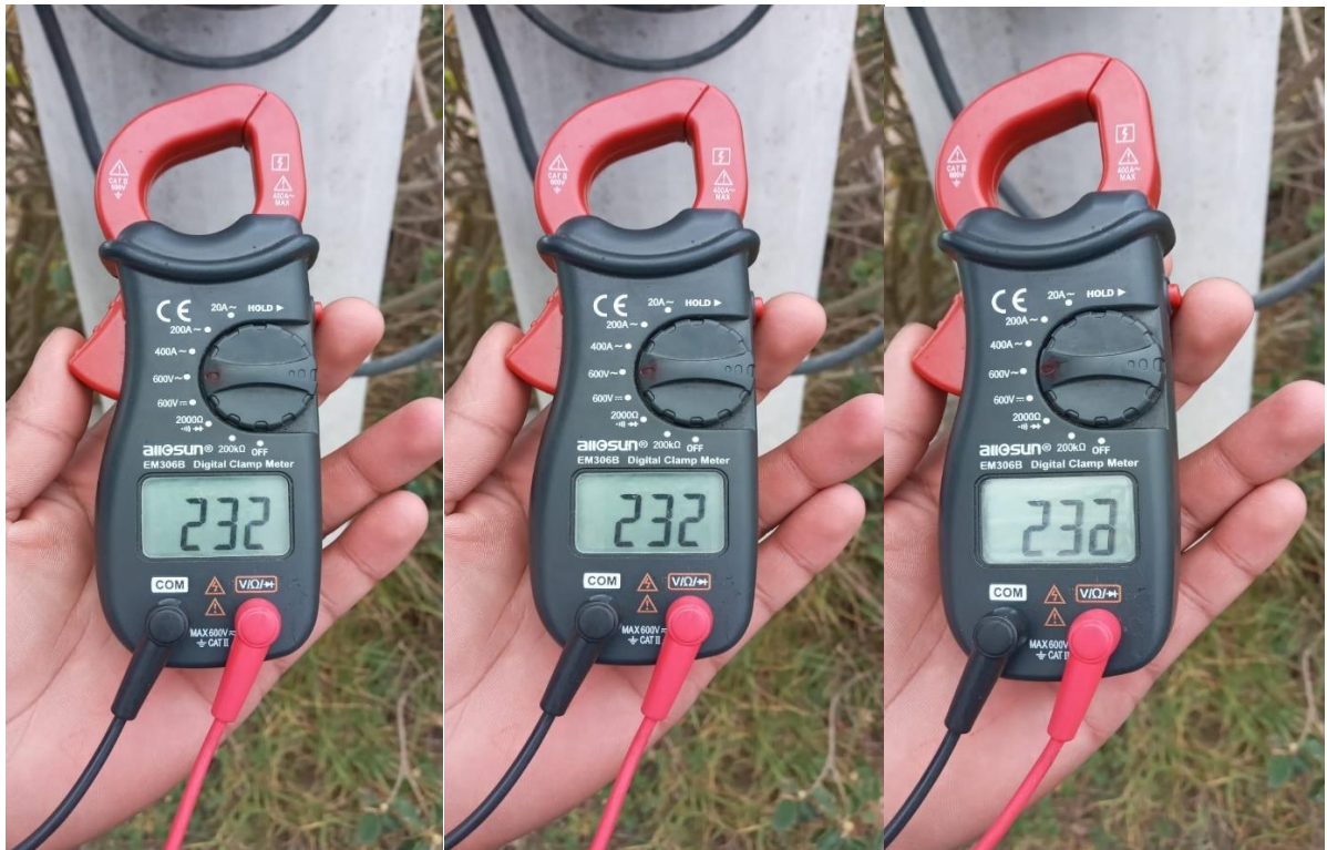
Imagen 3. Medida de tensión en la acometida.
