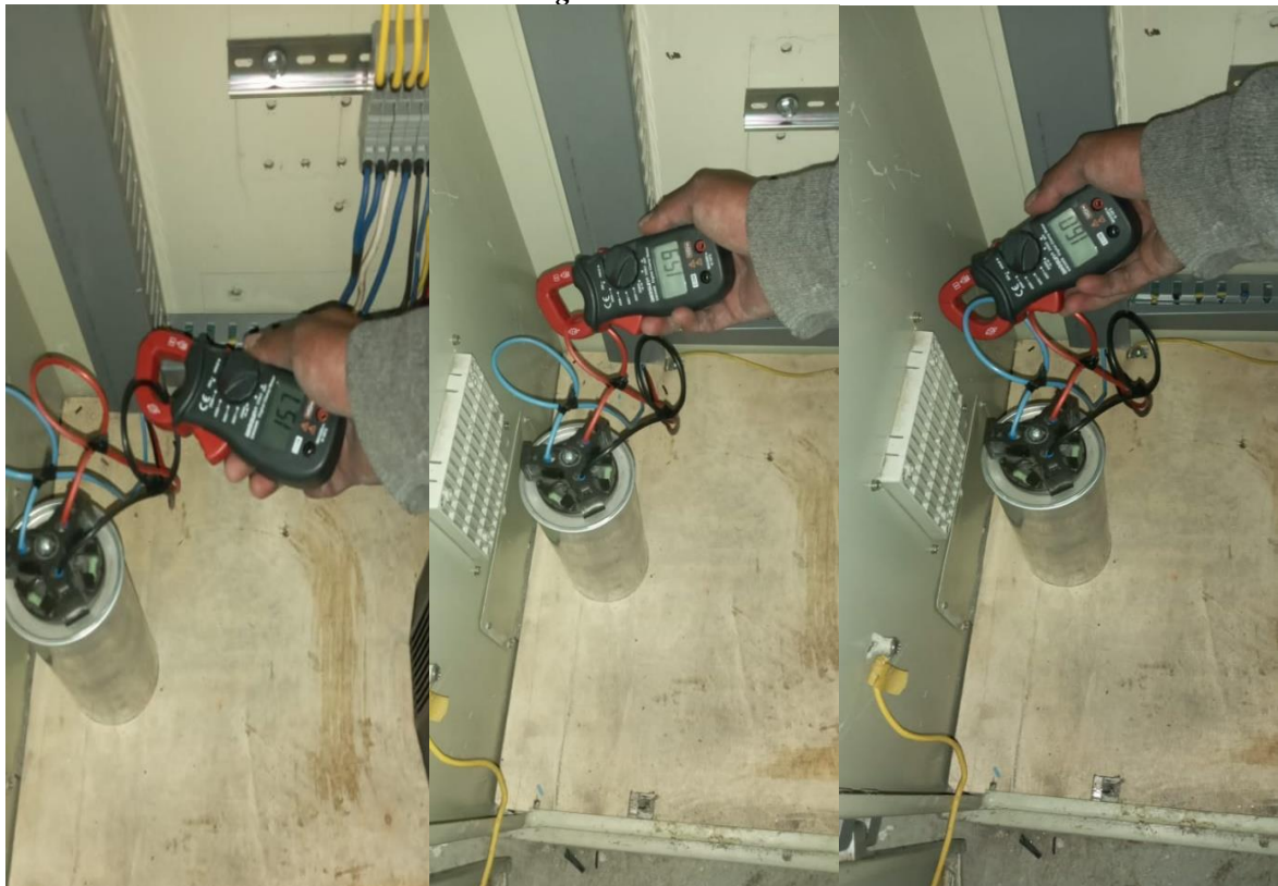
Imagen 17. Medición de corriente capacitor L1, L2 y L3. (en banco de condensador).
