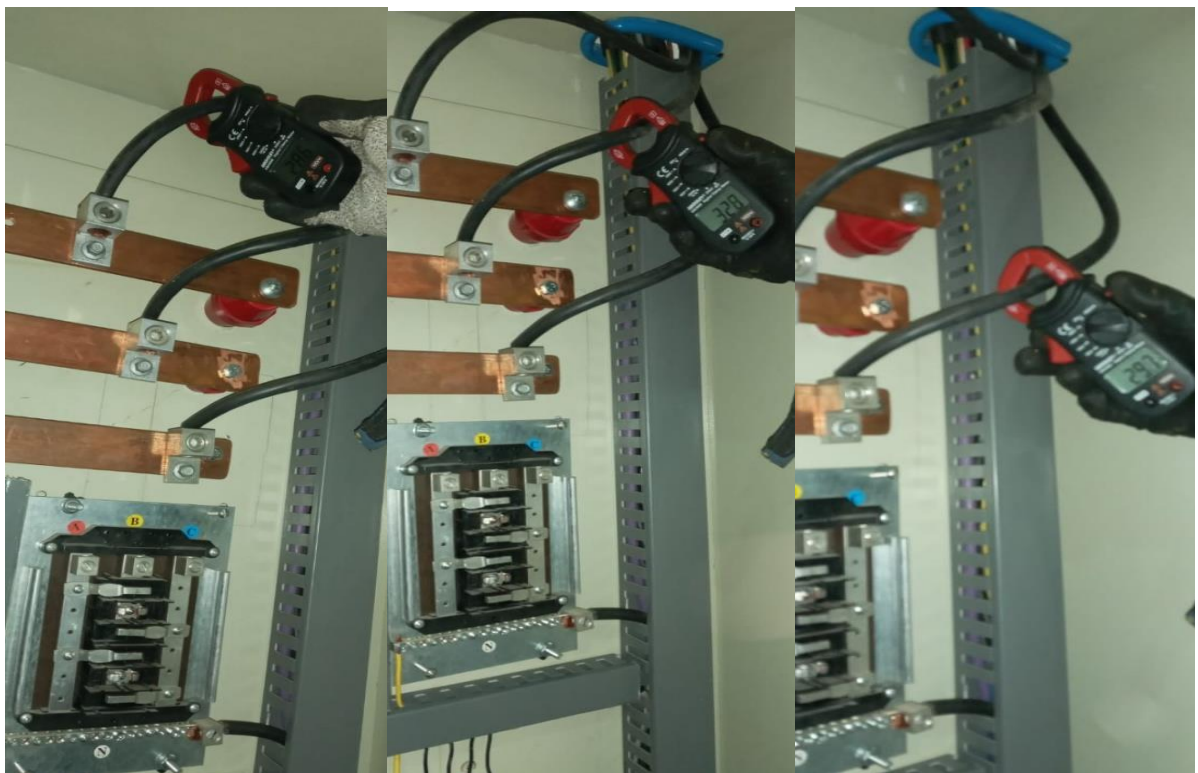
Imagen 13. Medición de corriente L1. (Carga distribuida a todo el sistema).
