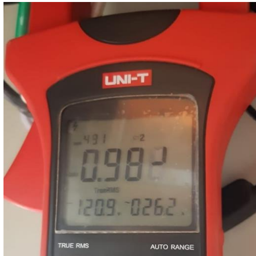
Figura 4.1 Medición del factor de potencia de tablero de control de la bomba centrífuga.
