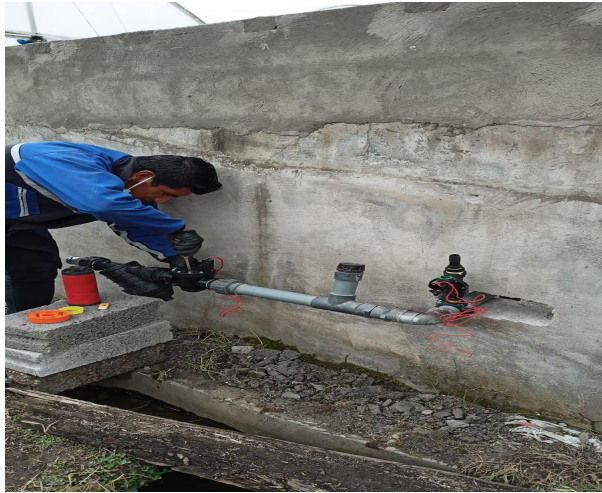
Anexo A.1. Ajuste de electroválvulas de 1''1/2 en sistema de bombeo
