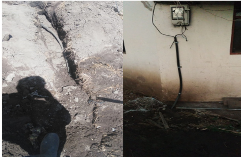
Anexo N.1. Excavación de acometidas, para alimentación del medidor hacia circuito en la caja térmica
