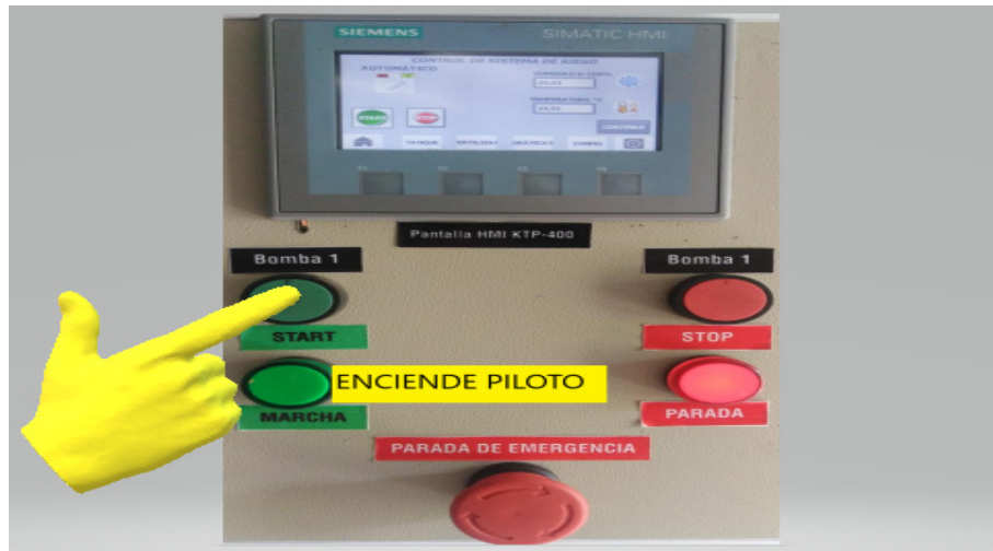
Anexo P.27. Encendido de bomba de agua en tablero de control.
