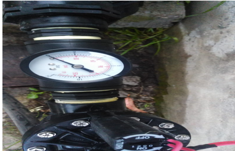
Anexo L.1. Enroscado de manómetro con Teflón en la salida de la bomba.
