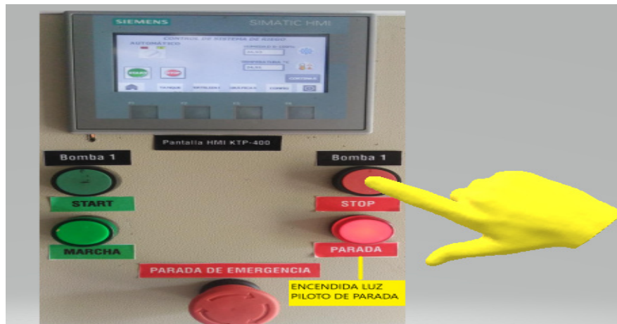
Anexo P.28. Desactivación de bomba de agua.
