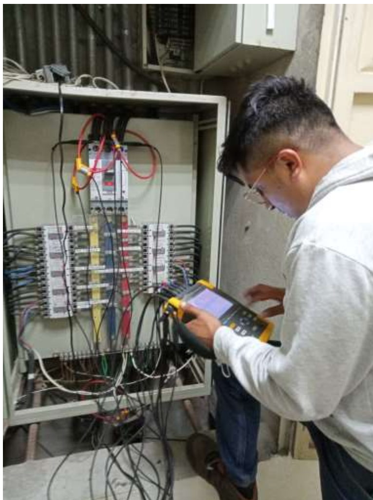
Figura 4. 6: Verificación de funcionamiento de equipo de medición.
