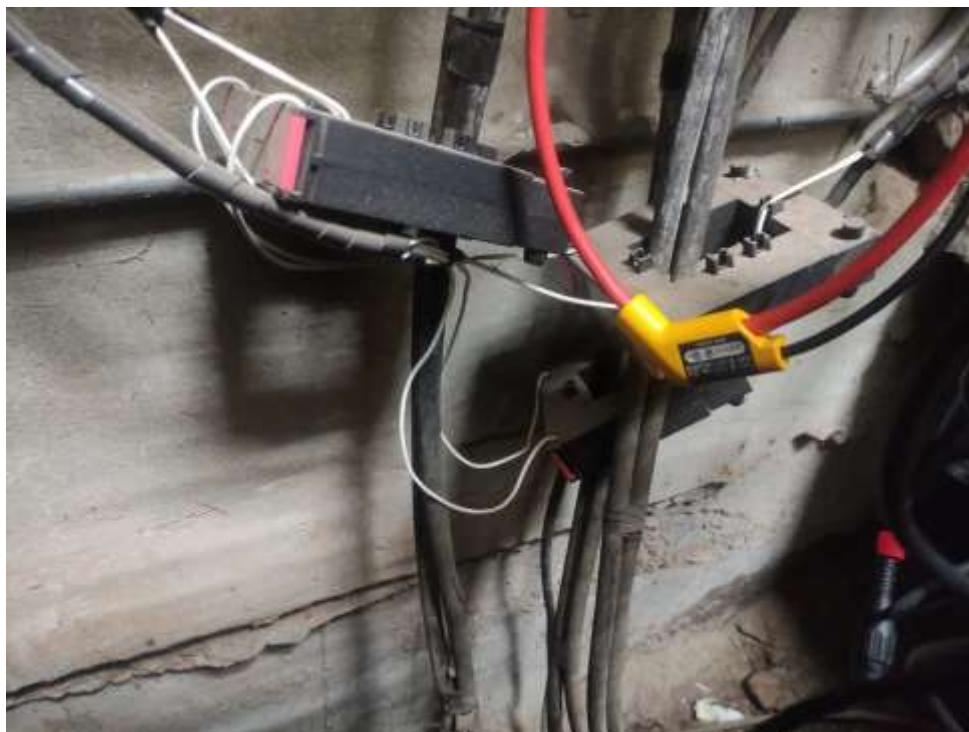
Figura 4. 4: Conexión de analizador de red Fluke 435 a tablero general de distribución.
