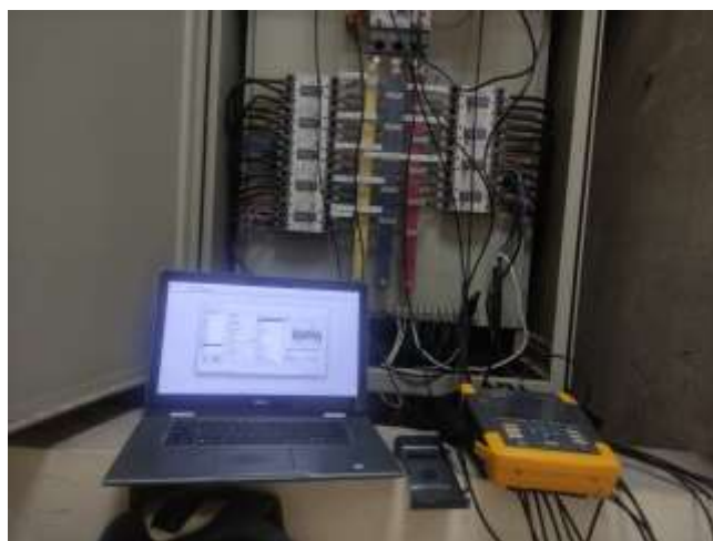
Figura 4. 8: Vinculación entre Analizador de red FLUKE 435 y software Power Log para análisis de datos.
