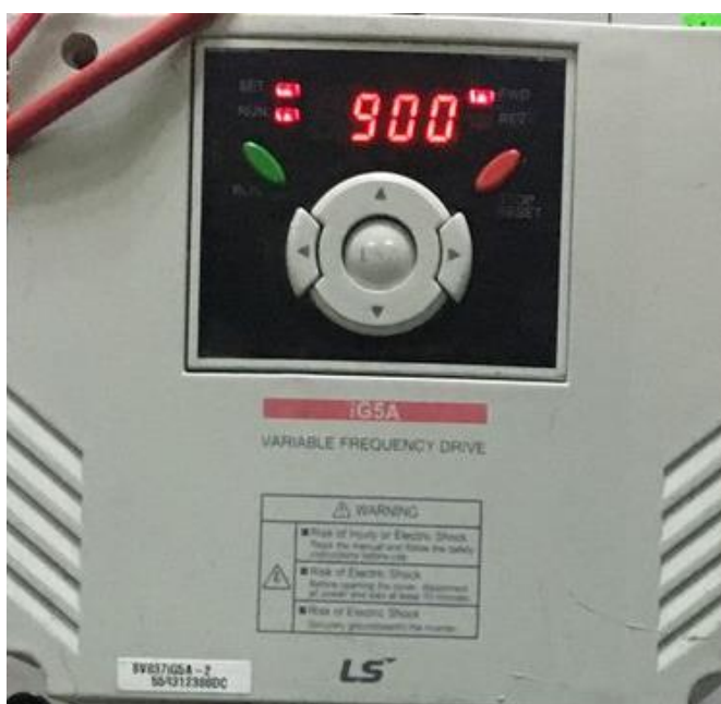
Figura 5.1 Medición de revoluciones en el variador de frecuencia.
