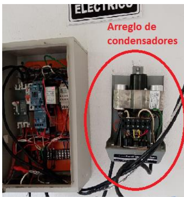
Figura 4.2. Arreglo de condensadores.
