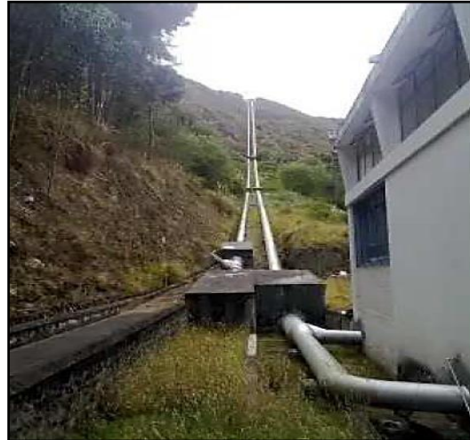
Figura 4.4. Tubería de presión perteneciente a la central hidroeléctrica ILLUCHI II [37].
