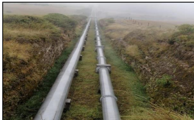
Figura 4.3. Tubería de presión perteneciente a la central hidroeléctrica ILLUCHI II.
