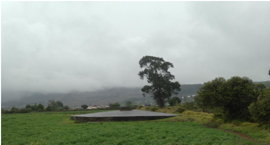
Figura 35 Tanque rompe presión
