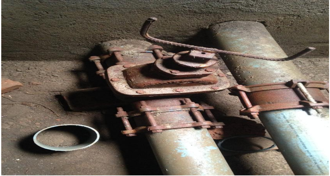
Figura 36 Válvulas tanque rompe presión
