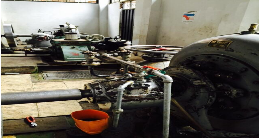
Figura 34 Estación de Bombeo
