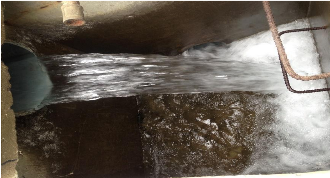
Figura 38 Caja de Distribución de Agua
