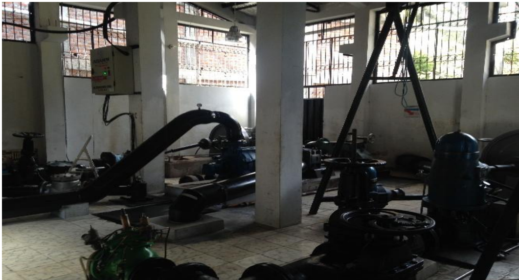
Figura 33 Estación de Bombeo
