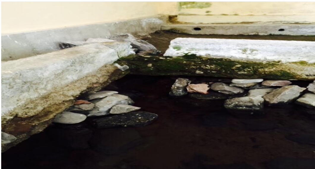
Figura 32 Captación de agua
