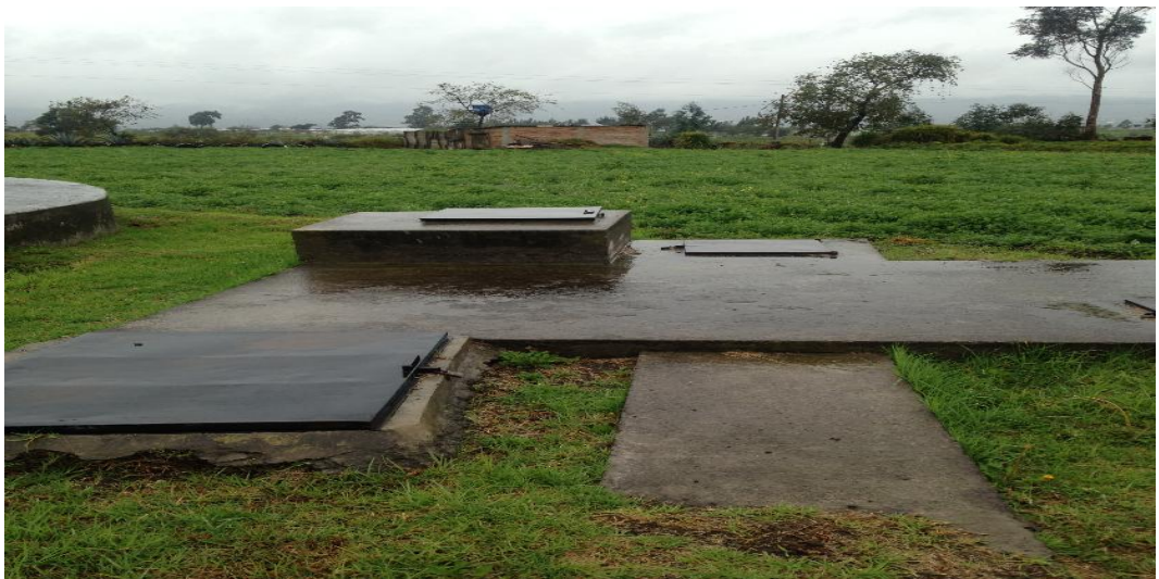
Figura 37 Caja de Distribución de Agua
