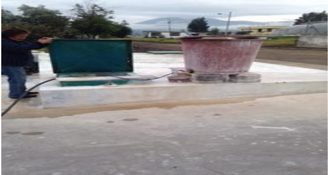
Figura 40 Tanque de cloración
