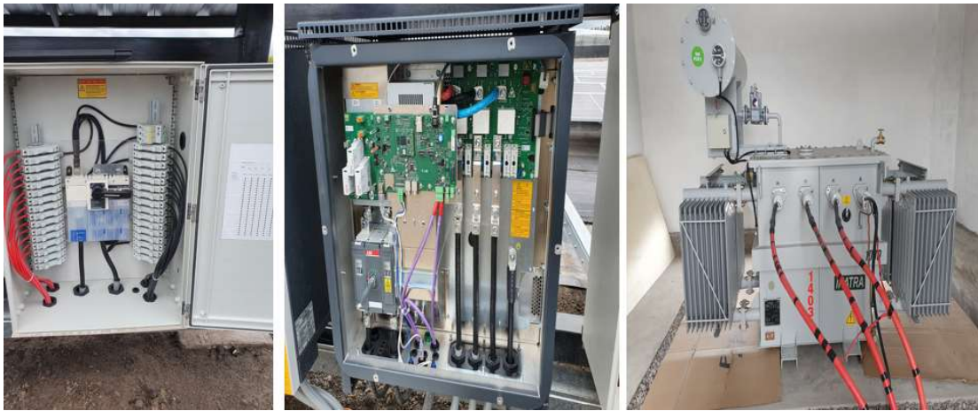
Figura 6 Sistema de inversión y transformador Provefrut 2021
