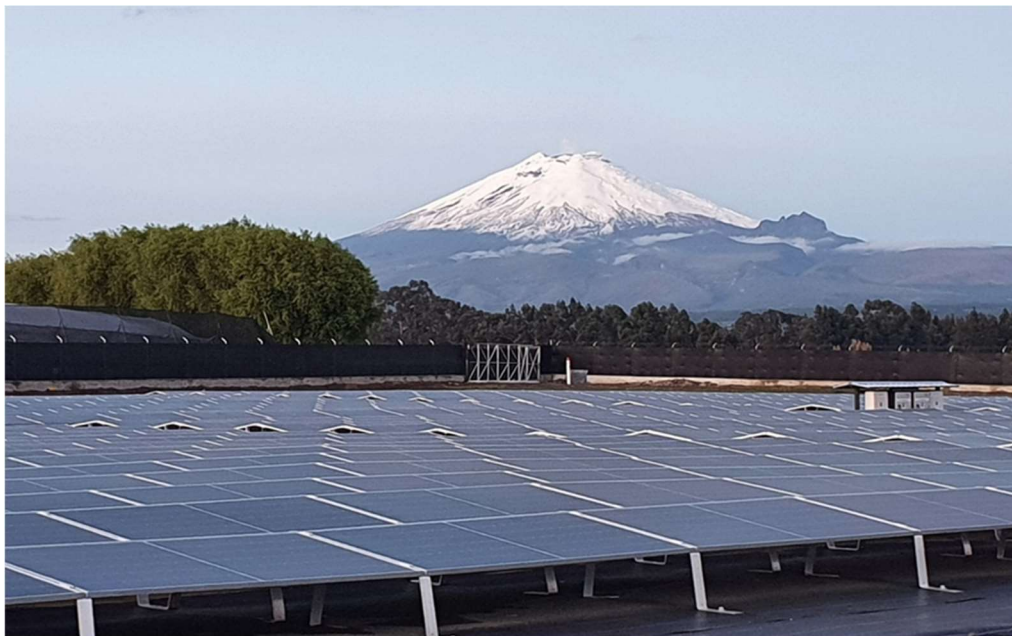
Figura 4 Planta solar 1 MW Provefrut 2021
