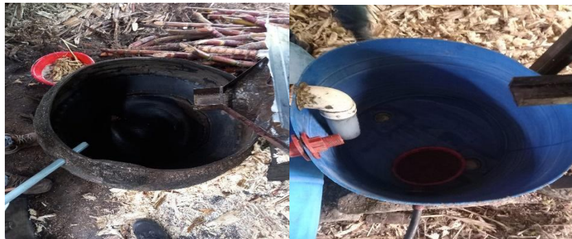
Ilustración 18. Pre limpiadores inadecuados.
