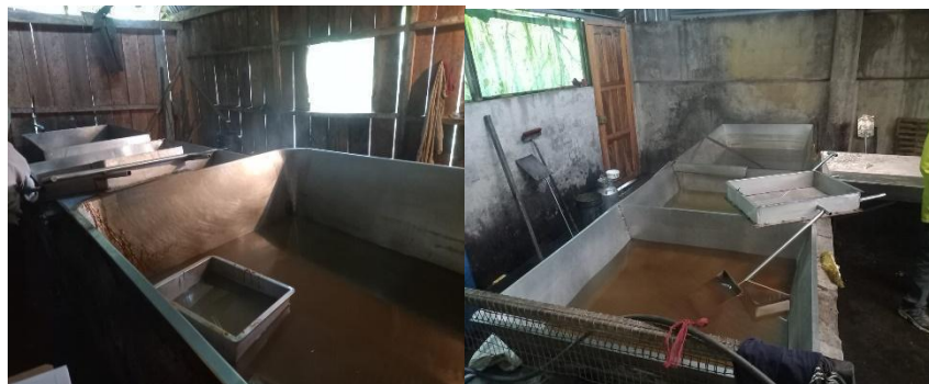
Ilustración 7. Paredes en condiciones inadecuadas.
