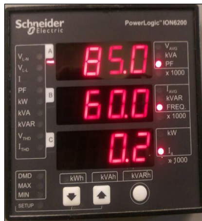
Figura 2.2: Medición Real de Factor de Potencia, Frecuencia y Corriente. Fuente: Elaboración propia en Laboratorio de Control de Calidad de la Refinería Shushufindi (2018).
