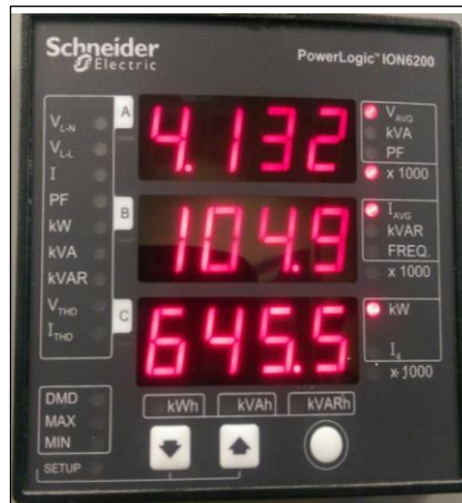
Figura 2.1: Medición Real de Tensión, Corriente Media y Potencia Activa. Fuente: Elaboración propia en Laboratorio de Control de Calidad de la Refinería Shushufindi (2018).
