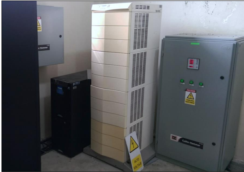
Figura 4.3: Equipos UPS y Tableros de Distribución. Fuente: Refinería Shushufindi (2018).
