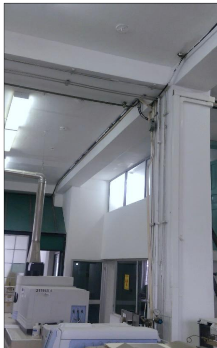
Figura 4.7: Instalaciones Eléctricas Superficiales. Fuente: Refinería Shushufindi (2018).
