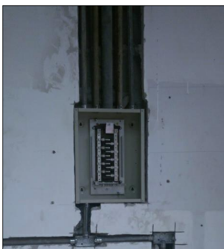
Figura 4.5: Tablero de distribución de UPS 01. Fuente: Refinería Shushufindi (2018)
