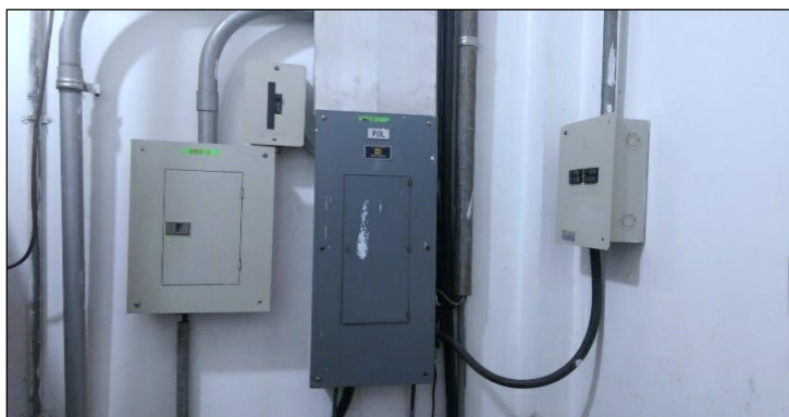
Figura 4.4: Cuarto Central de Aire Acondicionado. Fuente: Refinería Shushufindi (2015).
