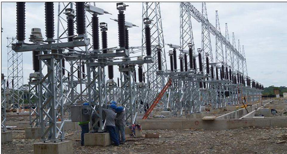
Figura 1.5: Estación de distribución eléctrica y los elementos que lo conforman. Fuente: Subestación Shushufindi de 300 MVA / 230KV.
