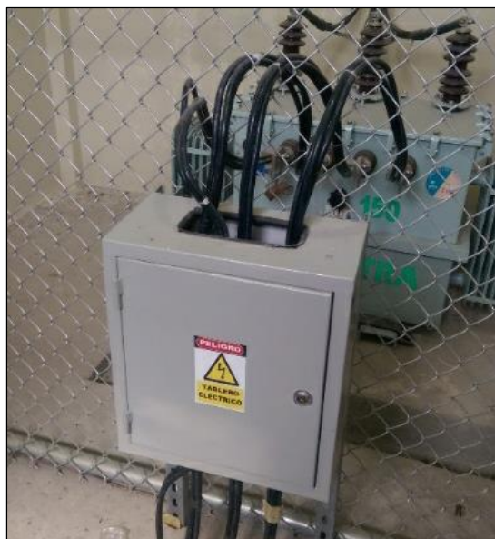
Figura 4.2.: Cámara de Transformación. Fuente: Refinería Shushufindi (2018)
