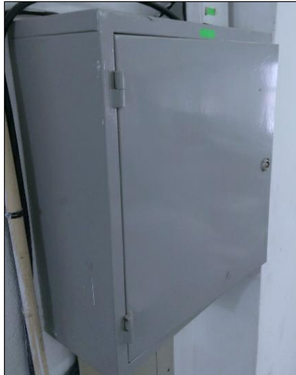
Figura 4.6: Tablero de distribución TDL 03. Fuente: Refinería Shushufindi (2018).
