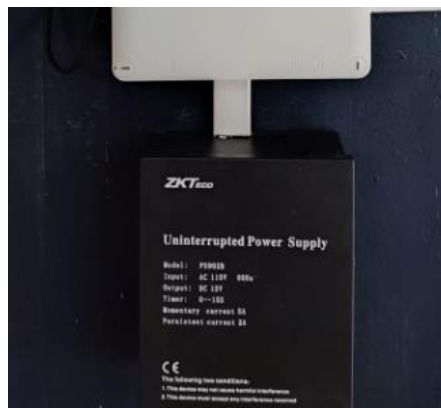
Figura 56. Ubicación del sistema de respaldo de energía.
