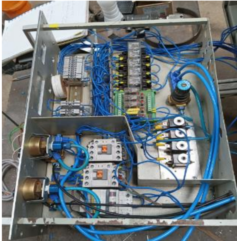
Figura XIX.50: Cableado eléctrico y neumático en la caja 1.
