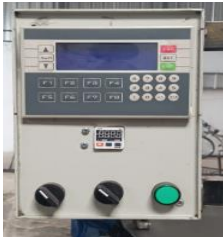
Figura XIX.51: PLC y elementos de mando en la caja 2
