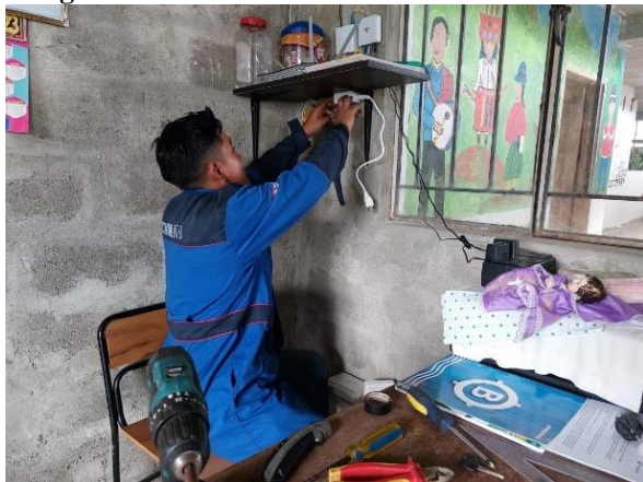
Imagen 19. Conexión de la antena a la red local
