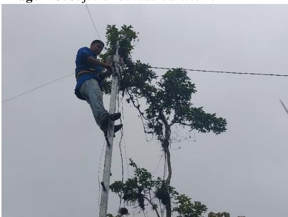
Imagen 13. Sujeción del cable a la torre
