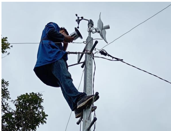
Imagen 21. Montaje de anemómetro y pluviómetro
