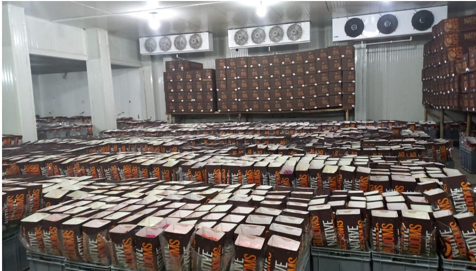
Figura 8. Cuarto frío para almacenamiento
