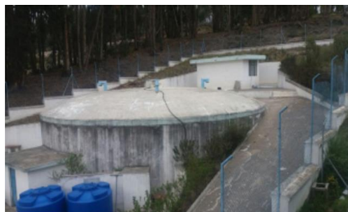
Fotografía 3. Falta de mantenimiento, ausencia de control de plagas.
