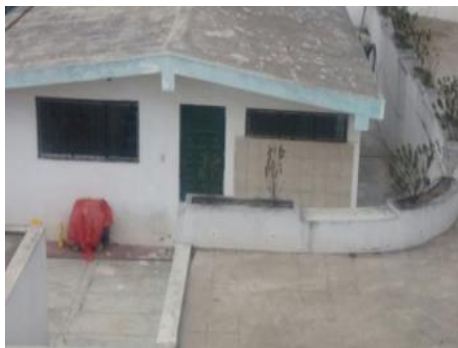
Fotografía 12. Área de control de calidad, sin mantenimiento y señalética industrial.
