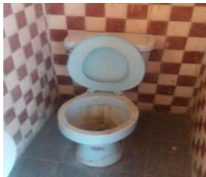
Fotografía 18. Falta de mantenimiento de baños y vestidores, sin disposición de jabón líquido, gel antiséptico y toallas desechables para manos.
