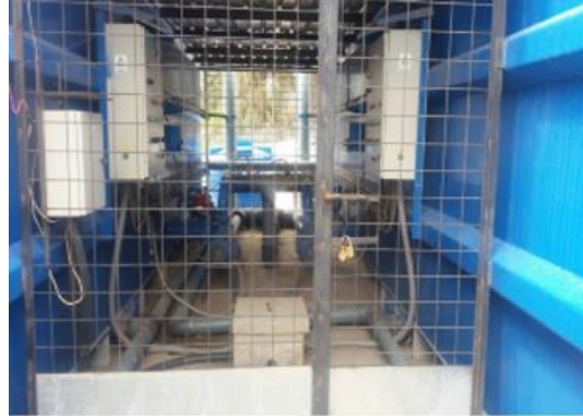
Fotografía 1. Falta de orden y limpieza, necesario señalética industrial y sistema contra incendios.
