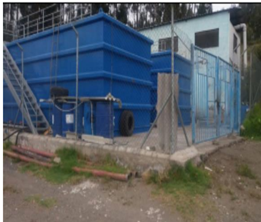
Fotografía 5. Ingreso a la planta de tratamiento de agua. Falta de señalética informativa.
