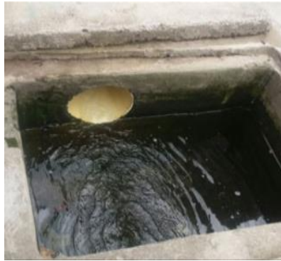
Fotografía 7. Caja de control de ingreso de agua cruda sin tapa de seguridad.
