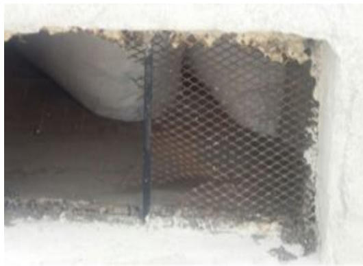
Fotografía 8. Bodega de almacenamiento de insumos químicos sin protección y seguridad industrial.
