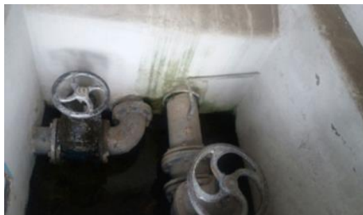
Fotografía 6. Caja de válvulas de control sin mantenimiento.
