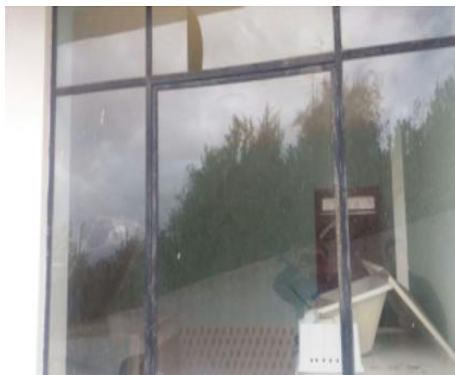
Fotografía 9. Área de desinfección, falta de seguridad industrial.
