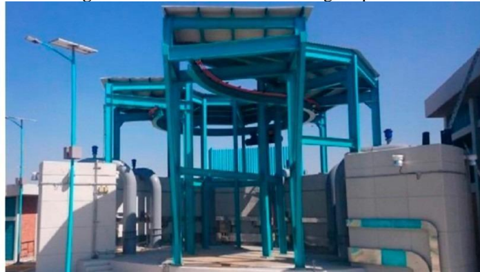
Figura 9. Sistema de Bombeo en aguas pluviales
