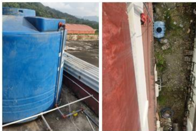
Figura 22. Condiciones anteriores del sistema de bombeo
