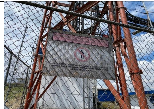
Foto 3. Señalética de prohibición de manipulación de las instalaciones de la EBC
