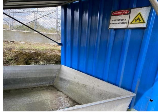
Foto 2. Presencia de cubeto para prevención de derrame de combustibles.
