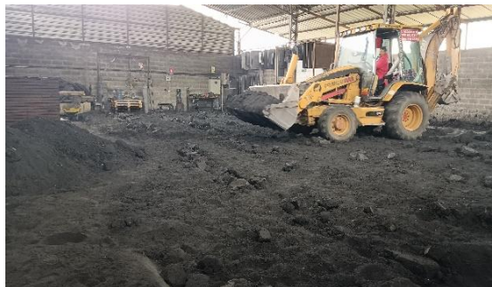
Figura 3.3: Recepción de arena refractaria.
