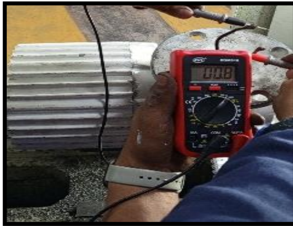
Figura 5.37. Verificación de energía con multímetro
