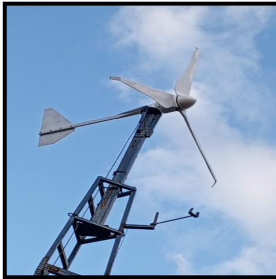
Figura 5.40. Vista completa de aerogenerador ensamblado
