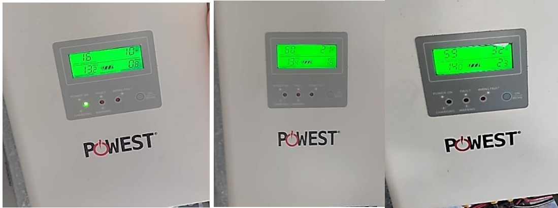
Figura 4.17. Toma de datos del regulador y piranómetro en el horario de las 07:30 am, 9:00 am y 11:00 am.
