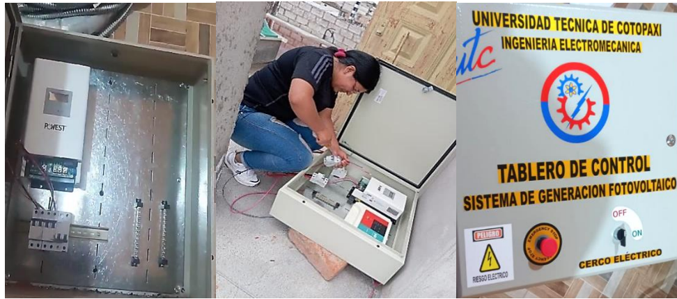
Figura 4.9. Conexión de los equipos en el tablero de control.
