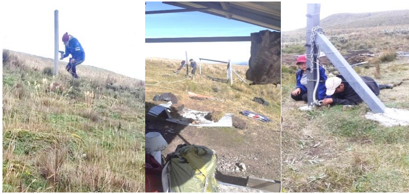
Figura 4.11. Conexión de la cerca eléctrica.
