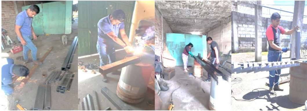
Figura 4.7. Proceso de la construcción de la estructura, corte, soldadura, limpieza y pintura.
