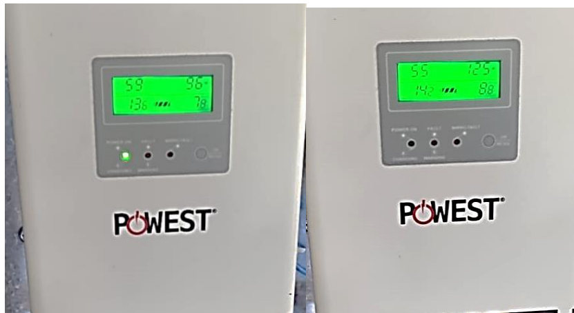
Figura 4.19. Toma de datos del regulador y piranómetro en el horario de 10:45 am y 13:00 pm.
