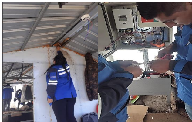
Figura 4.12. Conexión de iluminación y etiquetado de cables.
