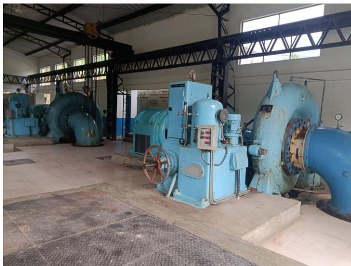
Figura 3.2 Cuarto de Máquinas de la Central Hidroeléctrica Catazacón
