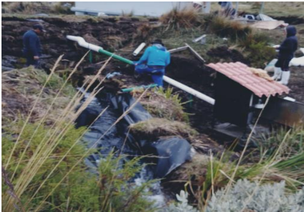
Ubicación de tubería
