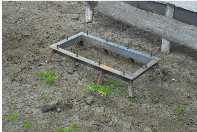
Figura: 3.35 BASE DE ASENTAMIENTO DEL EQUIPO MECÁNICO.
