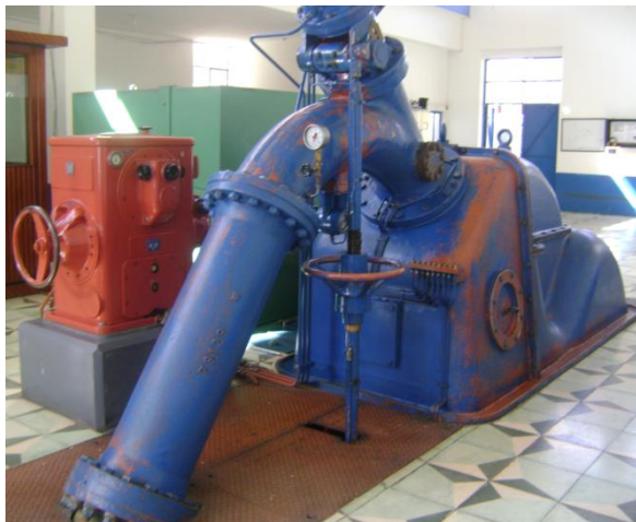
Figura 1.5 FOTOGRAFÍA DE EQUIPO ELECTROMECAÁNICO CON TURBINA PELTON.
