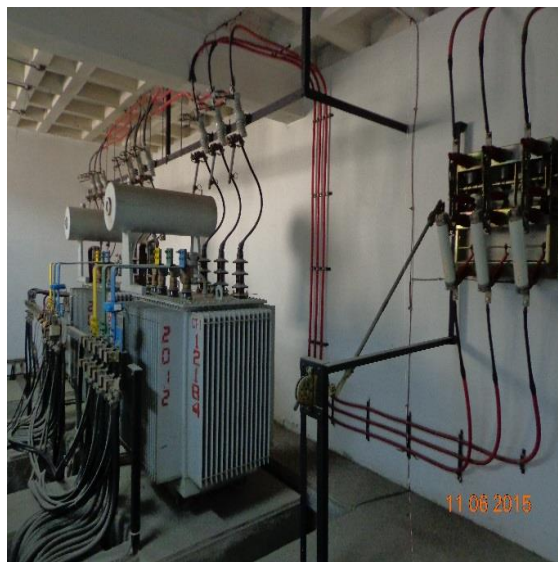
SECCIONADORES DE CADA TRANSFORMADOR
