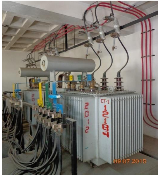
TRANSFORMADORES QUE POSEE ACTUALMENTE EL HOSPITAL
