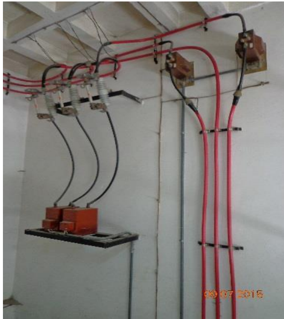
TRANSFORMADORES DE POTENCIAL Y CORRIENTE
