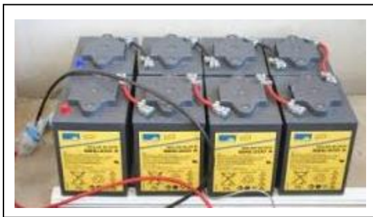
FIGURA 1.17: BANCO DE BATERÍAS
