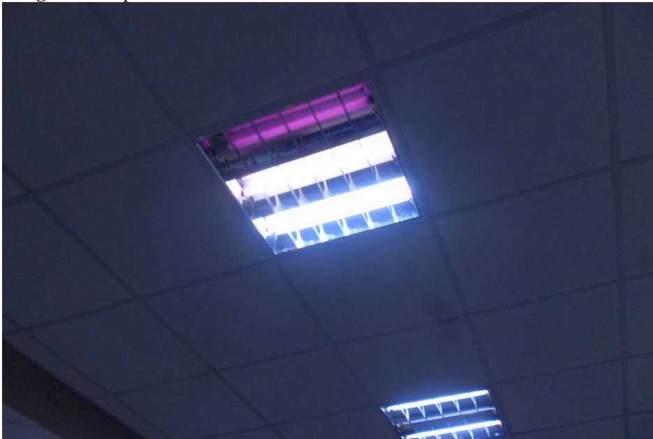
Imagen 6: Lámpara en mal estado
