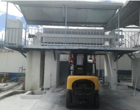
Figura 171: Filtro prensa para compactación de lodos en la planta de tratamiento.
