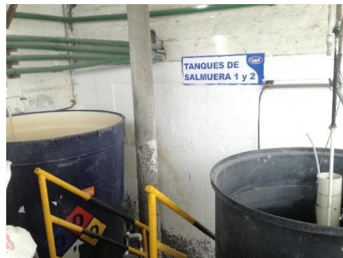
Figura 103: Tanques de salmuera.
