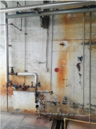
Figura 135: Purga de condensados de la tina N ° 25 de anodizado.
