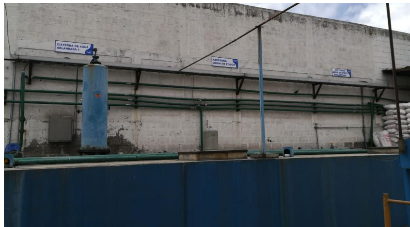
Figura 81: Semaforización de las cisternas de almacenamiento de agua primera etapa.
