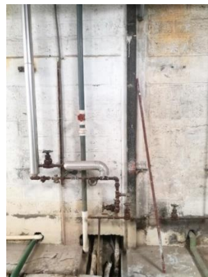
Figura 134: Purga de condensados de la tina N ° 24 de anodizado.
