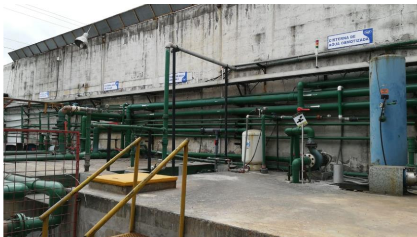
Figura 82: Semaforización de las cisternas de almacenamiento de agua segunda etapa.
