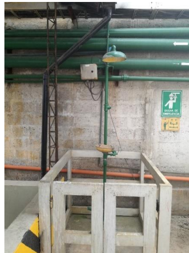
Figura 115: Ducha de emergencia del tanque de ácido en las cisternas de agua.
