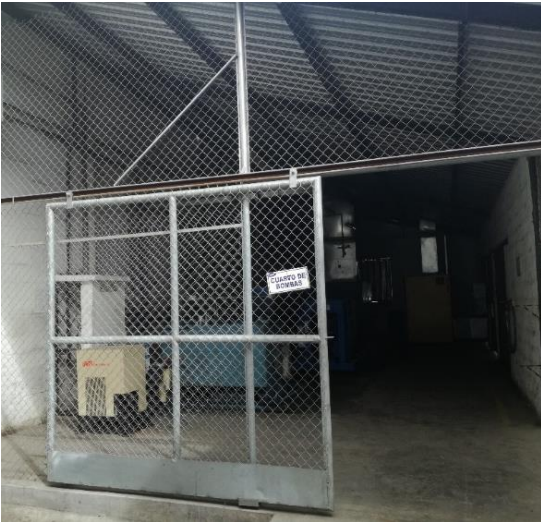
Figura 159: Cuarto de bombas.
