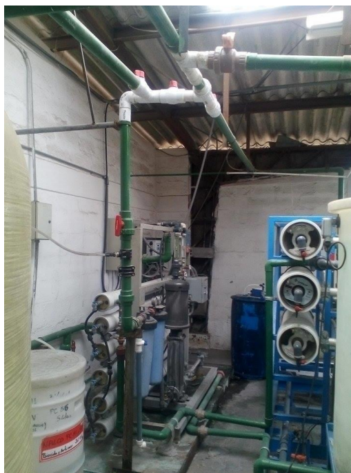
Figura 80: Cambio de membranas en los equipos de OI grande y pequeño.
