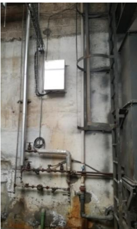
Figura 131: Purga de condensados de la tina N °5 de anodizado.
