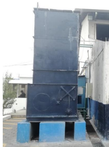
Figura 164: Torre de enfriamiento N ° 1 en fundición.
