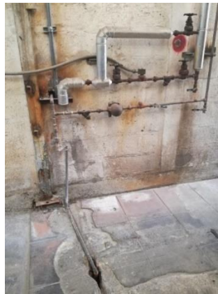
Figura 121: Purga de condensados de la tina N °1 de anodizado.
