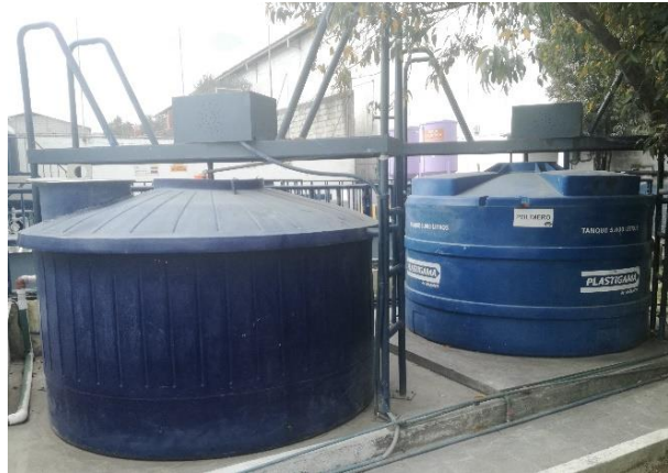
Figura 168: Tanques de polímero de la planta de tratamiento.
