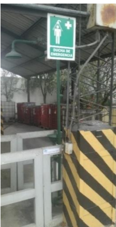
Figura 161: Ducha de emergencia de tanque de almacenamiento de ácido sulfúrico.
