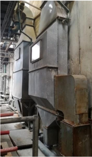
Figura 129: Extractor de vapor de la tina N ° 5 de soda caustica.
