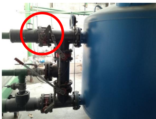
Figura 76: Filtro de arena vertical sin fugas de agua.
