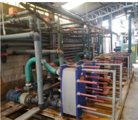
Figura 124: Intercambiadores de calor de anodizado.
