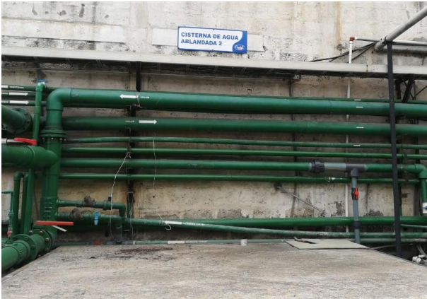
Figura 111: Cisterna N ° 6 de almacenamiento de agua ablandada.
