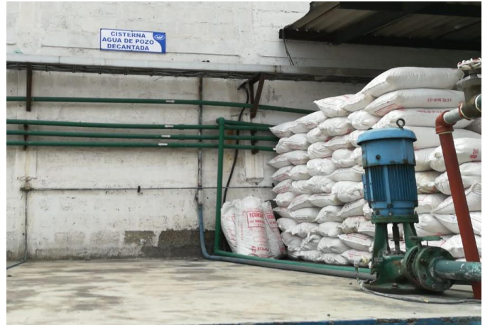
Figura 108: Cisterna N ° 3 de almacenamiento de agua dura decantada.
