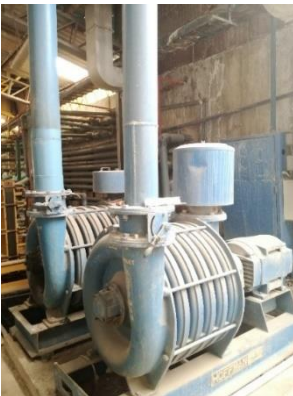
Figura 130: Blowers, generación de aire.
