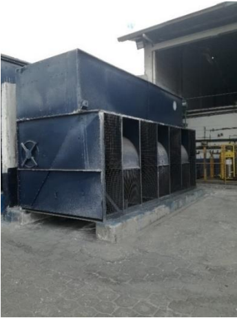
Figura 165: Torre de enfriamiento N ° 2 en fundición.
