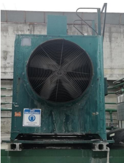
Figura 113: Torre de enfriamiento de agua ablandada.
