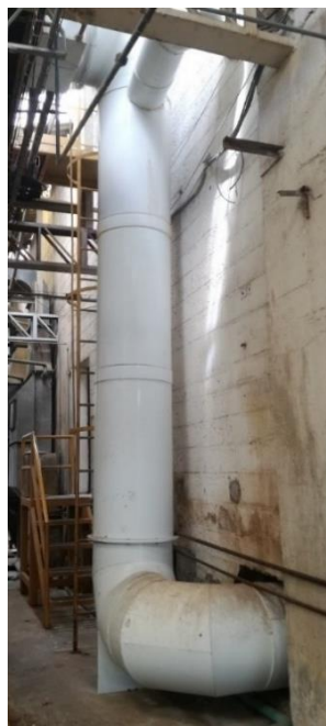
Figura 128: Extractor de vapor de la tina N °3 de AE.
