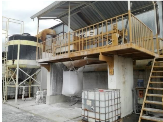
Figura 126: Filtro prensa para compactación de lodos en anodizado.
