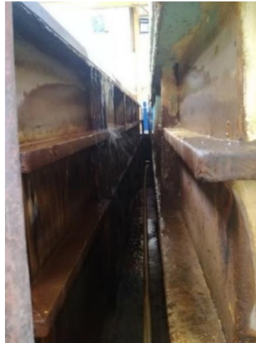
Figura 144: Pérdidas de agua por rebose en tinas del proceso de anodizado.
