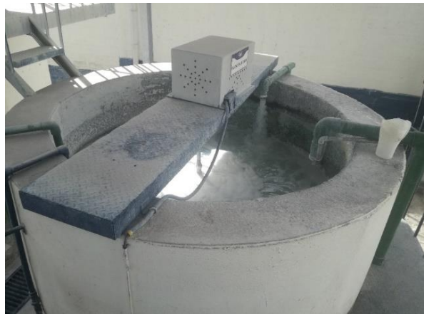
Figura 169: Floculador en planta de tratamiento.
