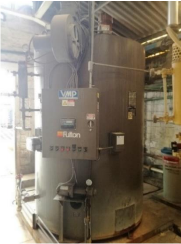
Figura 117: Caldera de generación de vapor N ° 1
