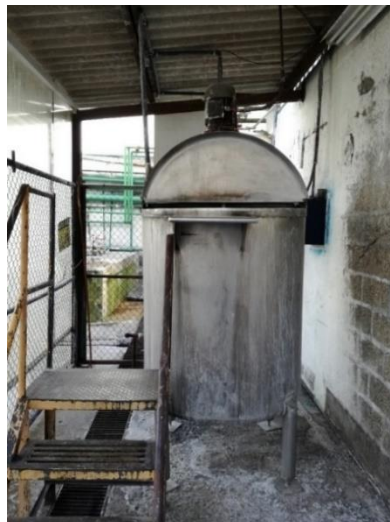
Figura 78: Tanque de dosificación de soda caustica de anodizado.
