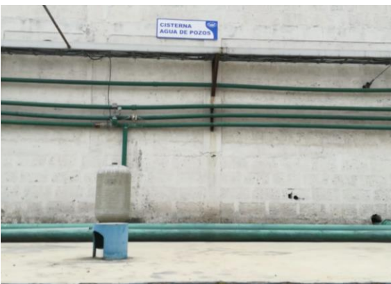
Figura 107: Cisterna N ° 2 decantación de agua dura.
