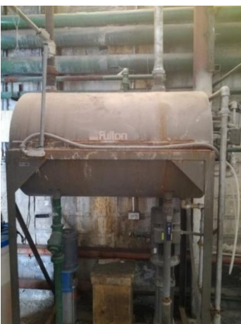
Figura 119: Tanque de condensado.
