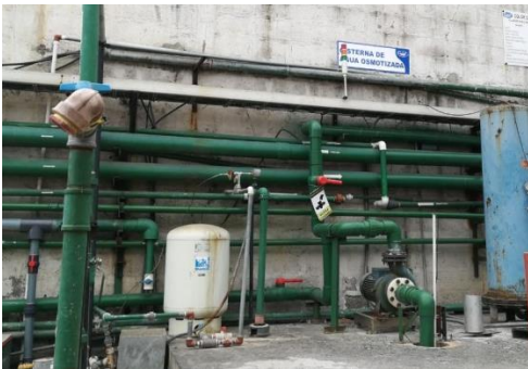
Figura 112: Cisterna N ° 7 de almacenamiento de agua osmotizada.
