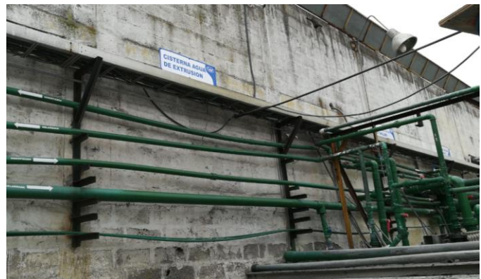
Figura 109: Cisterna N ° 4 de almacenamiento de agua ablandada.
