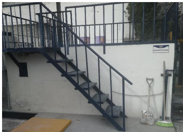
Figura 170: Sedimentador de agua en planta de tratamiento.
