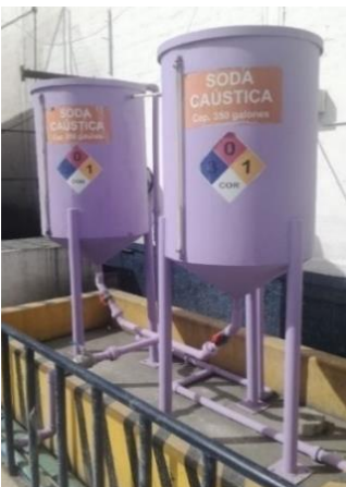
Figura 167: Tanques de soda caustica de la planta de tratamiento.
