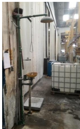
Figura 146: Ducha de emergencia del área de anodizado.
