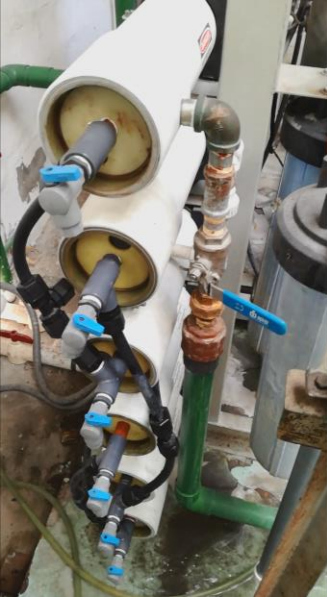
Figura 105: Sistema de ósmosis inversa pequeña.
