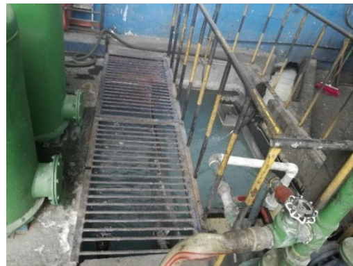
Figura 163: Cisterna de almacenamiento de agua en fundición.
