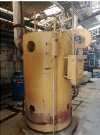
Figura 118: Caldera de generación de vapor N ° 2.
