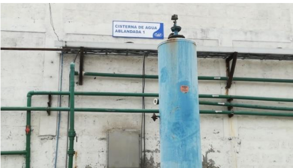
Figura 106: Cisterna N ° 1 de almacenamiento de agua ablandada.
