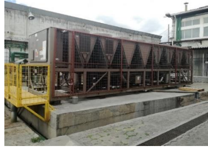
Figura 114: Chiller de enfriamiento de agua.
