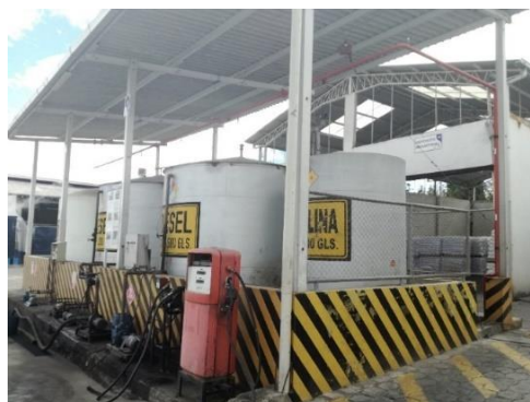
Figura 158: Sistema contra incendios para los tanques de combustible.
