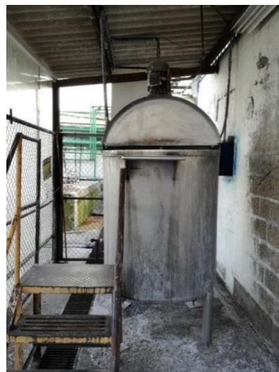
Figura 116: Tanque dosificador de Sosa Cáustica.
