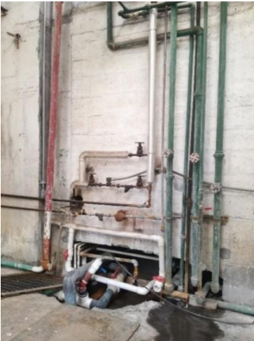
Figura 123: Purga de condensados de la tina N °3 de anodizado.
