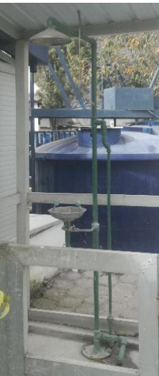
Figura 172: Ducha de emergencia de la planta de tratamiento.
