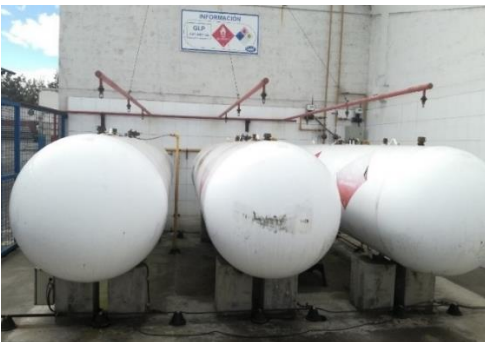
Figura 160: Sistema contra incendios tanques GLP.
