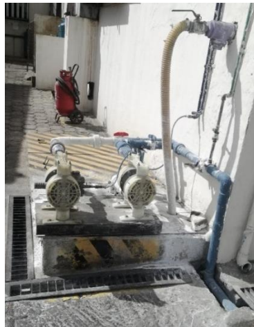
Figura 157: Preparación de soda para planta de tratamiento.
