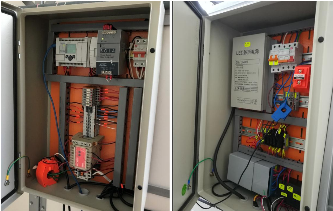
Figura 3.4. Cajas de conexiones eléctricas y de control (Fuente: José Baquero, autor)
