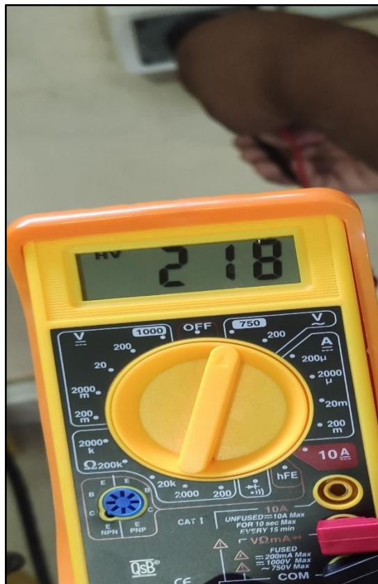
Figura 7: Comprobación de los tomacorrientes de 220V
