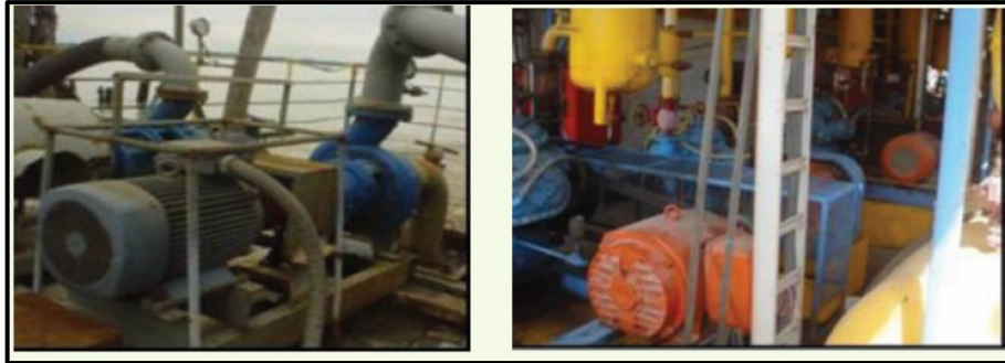
Figura 3.3. Motores eléctricos conectados a un compresor de refrigeración y a bombas centrifugas [6].
