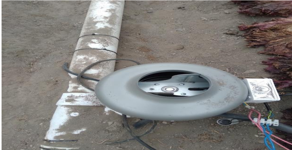
Anexo 15 Extractores internos, bajo cubierta.
