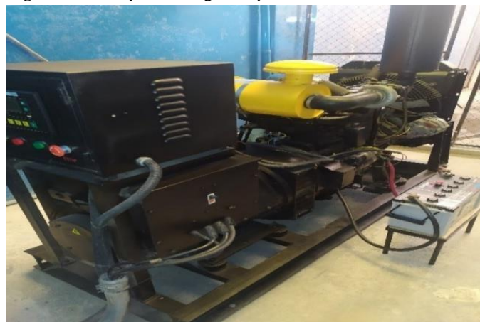
Figura 22. Grupo electrógeno operativo
