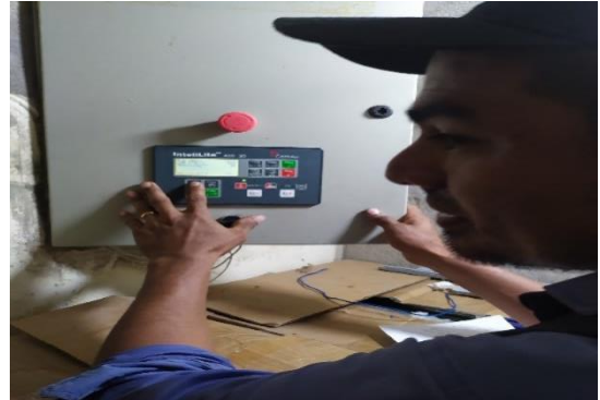
Foto 2. Puesta en funcionamiento tablero Automático ComAp intelLite AMF20.
