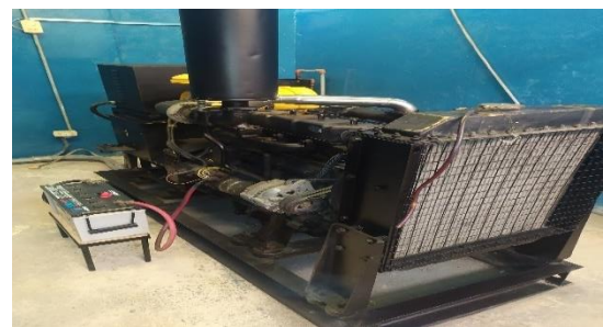
Foto 4. Grupo electrógeno operativo
