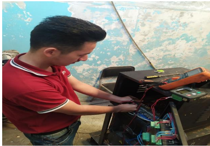
Figura 20. Comprobación del tablero de control
