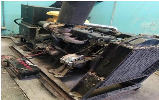
Foto 3. Grupo electrógeno Inactivo
