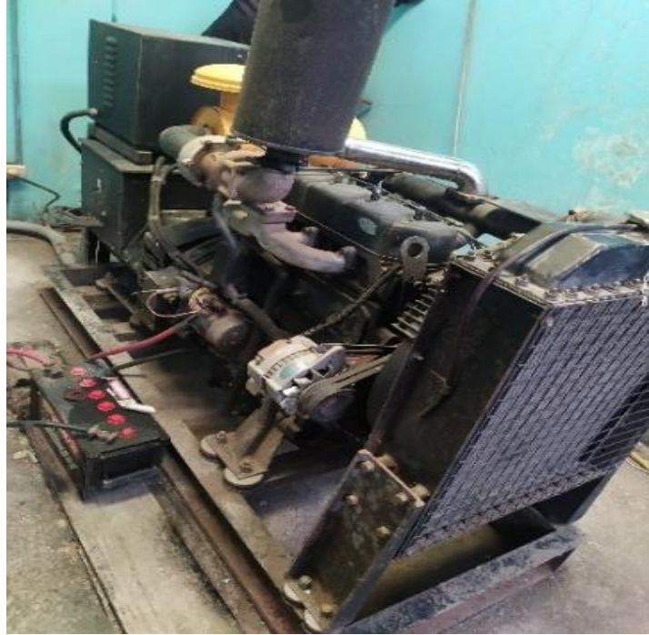
Figura 16. Grupo Electrónico Inactivo en el edificio de la UTC
