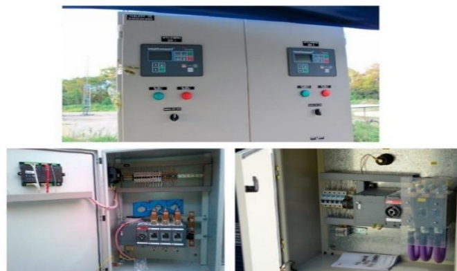
Figura 9. Tablero de Transferencia automática
