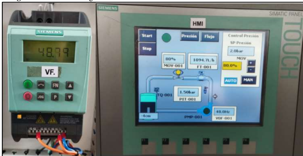
Imagen 24. Prueba de asignación de Frecuencia al Variador
