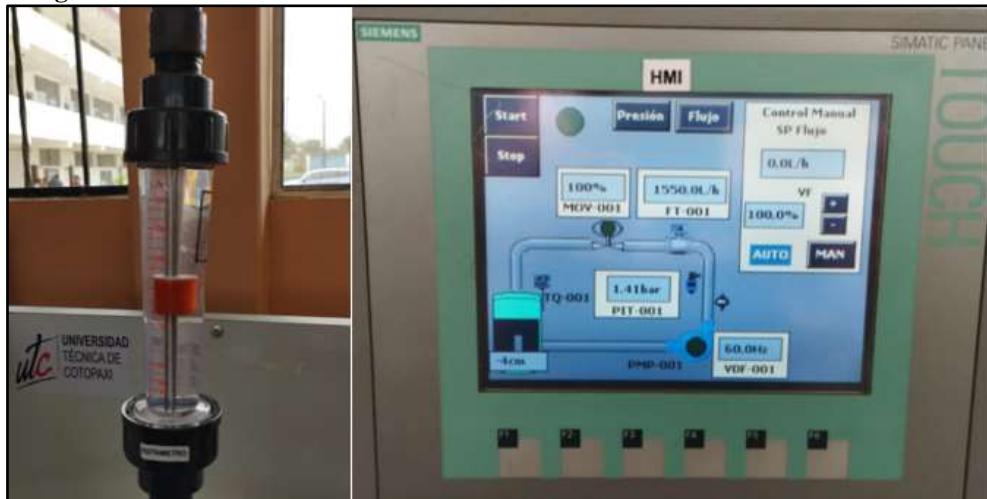
Imagen 19. Visualización del Rotámetro de Caudal montado en la tubería
