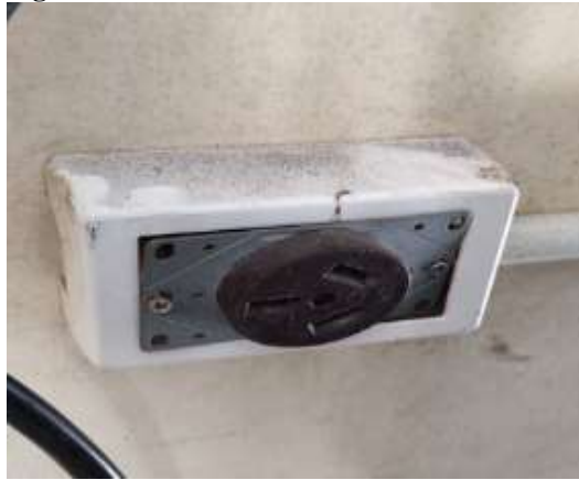
Figura 15: Toma corriente trifásico
