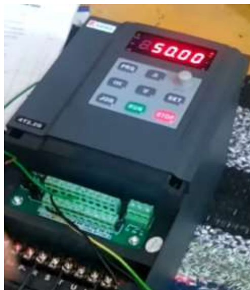
Imagen 17. Variador de frecuencia
