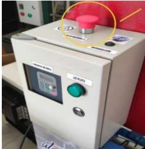
Imagen 18. Paro de emergencia
