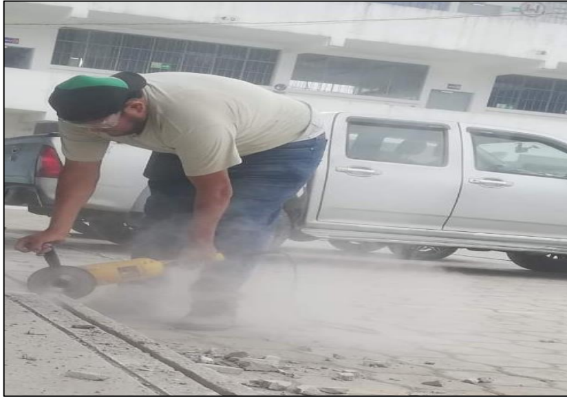
Fotografía 8: Rompimiento de la vereda del bloque ‘B’
