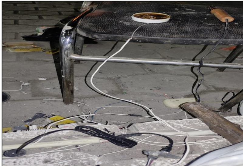
Fotografía 10: Conexión de cables para soldar.
