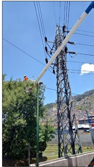
Figura 13. Torres de subtransmisión. Fuente: [22]
