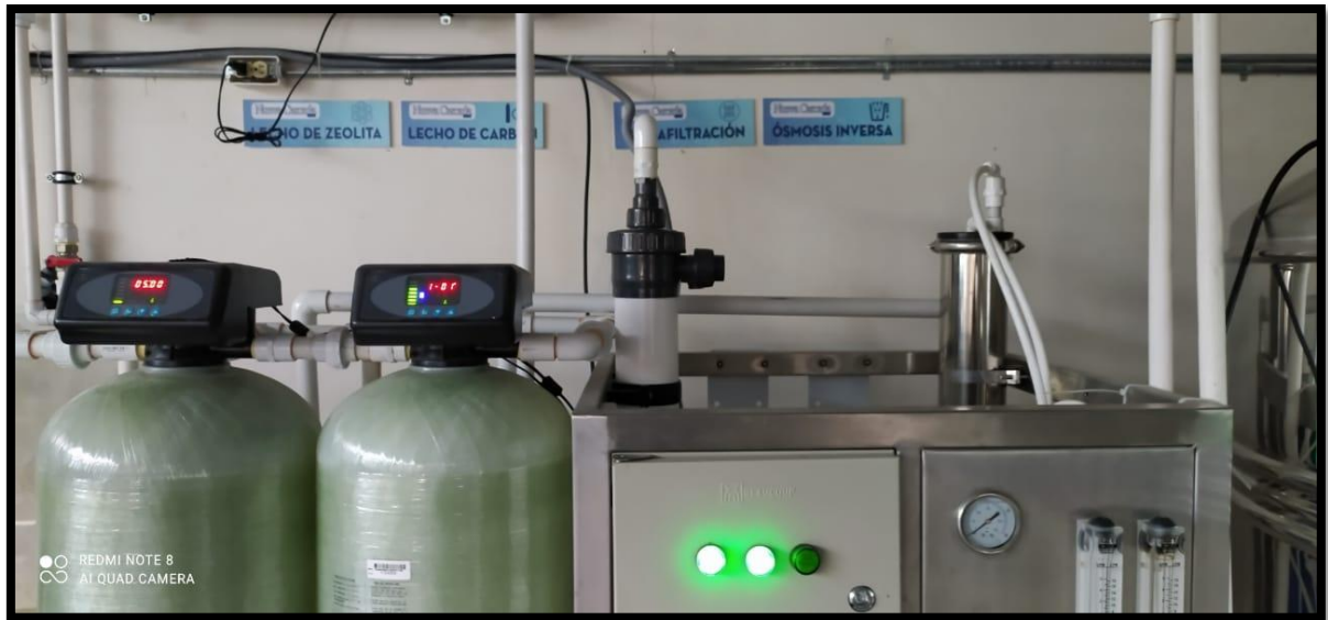
Figura G.1 Purificadora de agua
