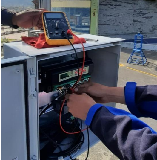
Anexo C-1: Medición de la frecuencia empleando el multímetro Fuente: Carrera Electromecánica
