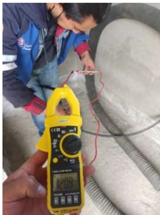
Figura C.5: Primeras mediciones entre líneas y neutro del transformador.
