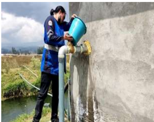
Figura 3.2: Cebado del sistema hidráulico.
