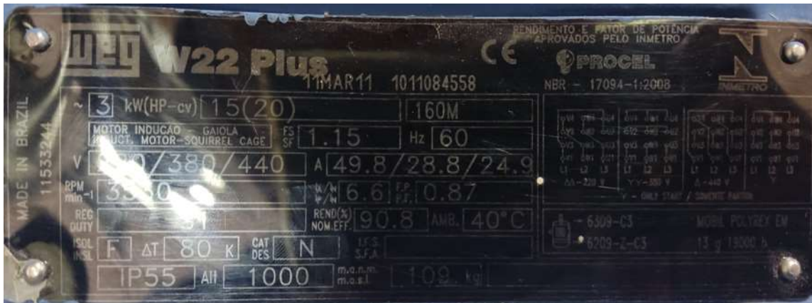
Figura E.1: Datos de placa de la bomba centrífuga.
