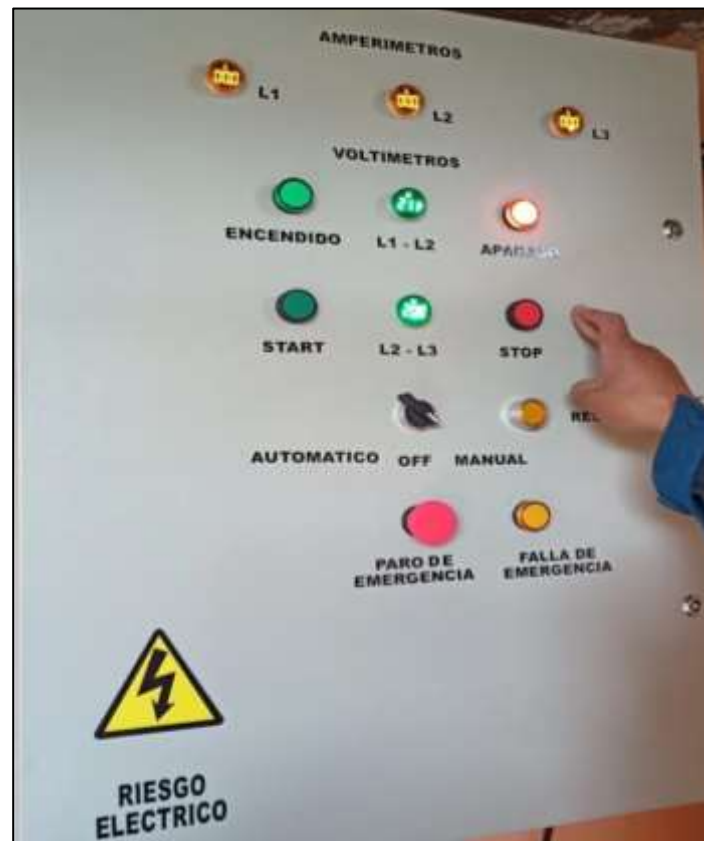
Figura 4.1: Tablero de control para operar en óptimas condiciones.
