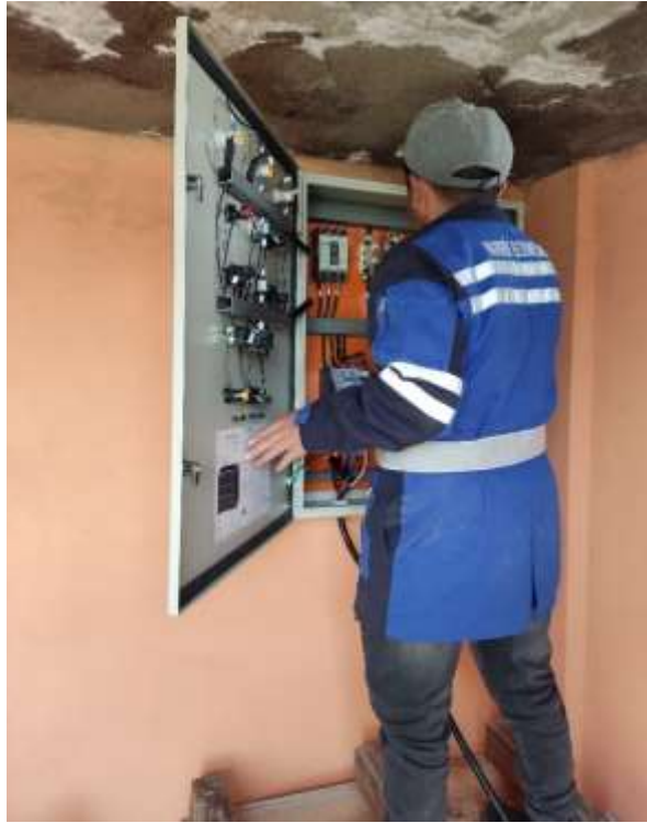
Figura E.3: Empotramiento del tablero de control.
