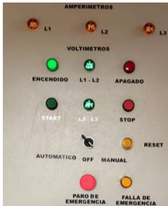
Figura F.2: Tablero de control Modo Manual.
