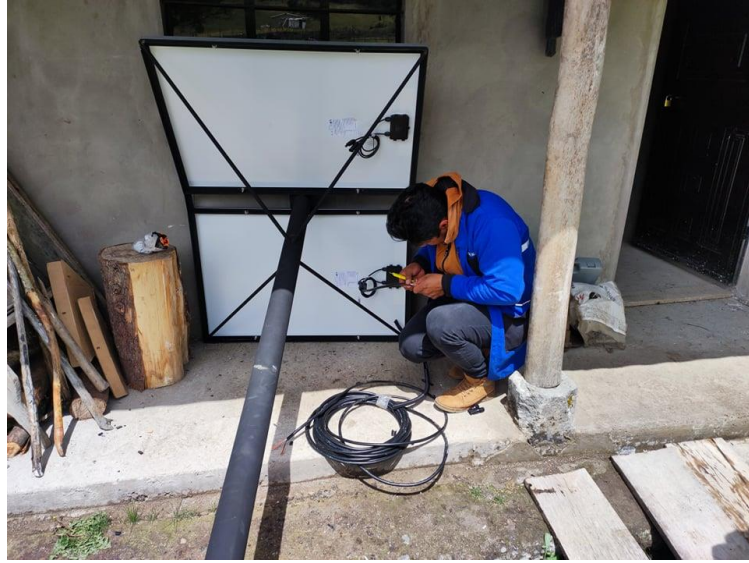
Fig. 5.5. Conexión de los módulos fotovoltaicos
