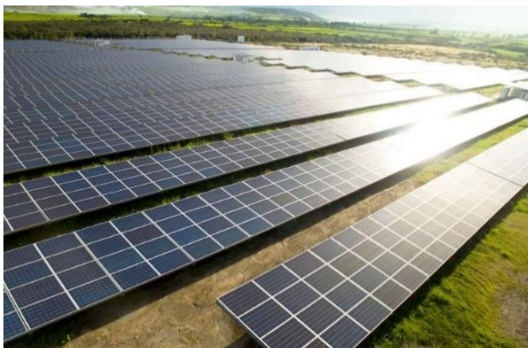
Figura 5.2 Parque fotovoltaico Salinas.
