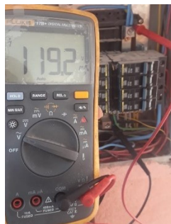
Figura 22. Medición de voltaje en una caja de distribución
