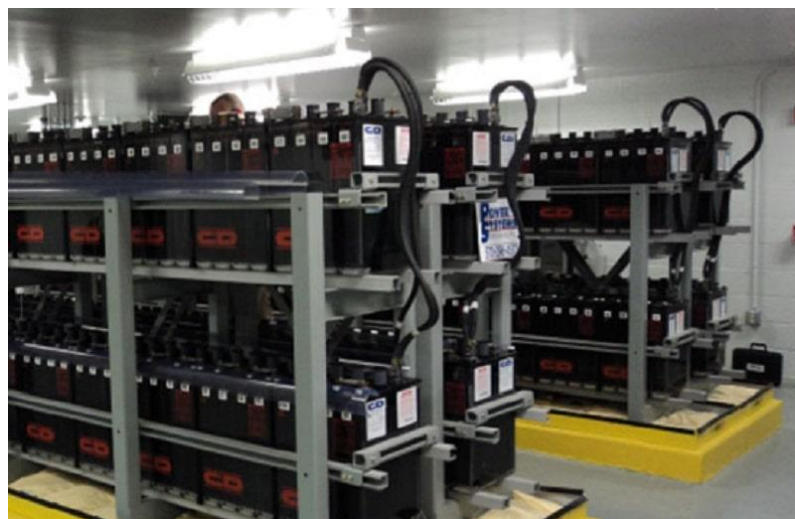
Figura 7: Sistema de almacenamiento de energía (banco de baterías) [23]
