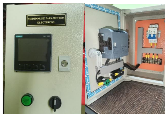
Figura 2.5. Panel de control del sistema de pico-generación.
